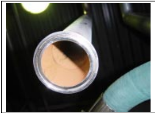
TRECHO DE TUBULAÇÃO COM ROUGE
