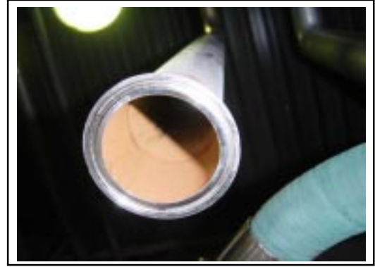
TUBULAÇÃO DE PROCESSO
