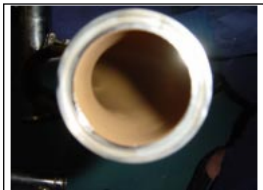
SISTEMAS DE ÁGUA DEIONIZADA
